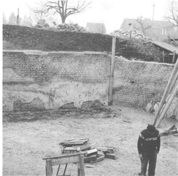
Abb. 21 Augst BL, Grabung 1961.60. Blick vom Inneren der Curia auf die Innenwand der Curiamauer (MR 1). Der massive Senkungsris ist auf das Unterhöhlen des Curiafundamentes beim Bau der jüngeren Basilika-Stützmauer zurückzuführen. Er ist heute durch moderne Restaurierungsarbeiten weitgehend beseitigt worden. Photo von den Restaurierungsarbeiten; Blick nach Norden.
