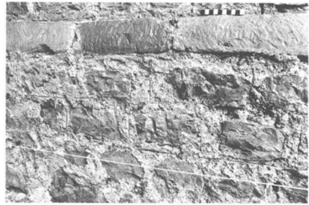
Abb. 26 Augst BL, Grabung 1990.53. Detail an der jüngeren Basilika-Stützmauer (MR 2). Die z.T. stark mit Mörtel verschmutzte Sandsteinfase und das noch in fast baufrischem Zustand erhaltene, mit Fugenstrich versehene Mauerwerk sind unmittelbar nach dem Hochziehen wieder mit einer Anböschung verdeckt worden (vgl. auch Abb. 20,C). Blick nach Westen.
