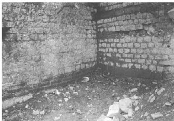
Abb. 6 Augst BL, Grabung 1908.60. Originalaufnahme der Baufuge zwischen Curiamauer (MR 1, links) und der jüngeren Basilika-Stützmauer (MR 2, rechts) von K. Stehlin. Das 1908(!) aufgenommene Bild ist eines der ältesten photographischen Dokumente der Augster Forschung.
