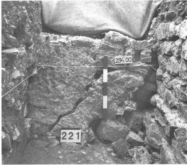
Abb. 18 Augst, Insulae 5 und 9 (Grabung 1993.65). Ansicht des freipräparierten Senkungsrisse in Mauer 3. Blick nach Süden. Zur Lage vgl. Abb. 14.
