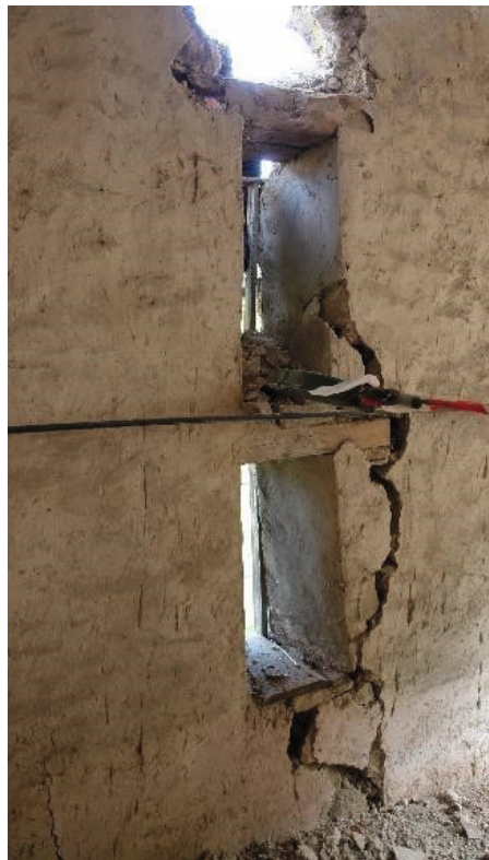
Abbildung 12: Ostfront vom Heuboden aus. Sichtbar auch die Zugstange, welche Nord- und Südfassade verbindet.
