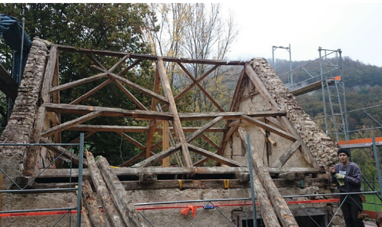
Abbildung 33: Demontage des Dachstuhls. Die Sparrenanlage ist bereits demon- tiert. Deutlich erkennbar die gebrochenen Andreaskreuze, der eingeknickte First und der abgesenkte Mittelbinder bei weggefalltem Bundbalken.
