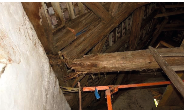
Abbildung 20: Typisches Schadensbild; abgefallener Stuhlstrebenfuss, schadhafter Mauerbalken und schadhafte Stuhlschwelle.
