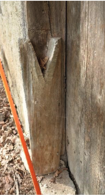
Abbildung 23: Absperrungsvorrichtung beim Heubodeneingang.
