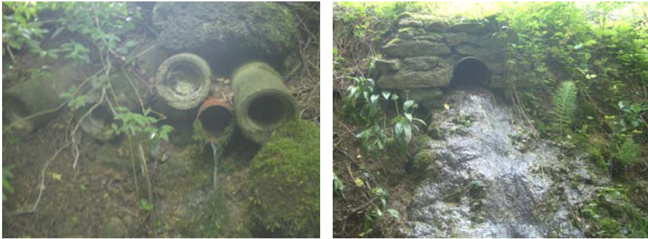
Abb. 3-6: Drainage-Direkteinlässe in den Länenbach.
